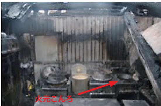
火災後のこんろ周り（糸魚川市消防本部提供）
